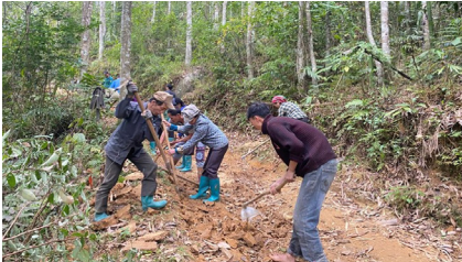
Bà con thôn Khuổi Lùng tạo mặt bằng để đổ bê tông.
